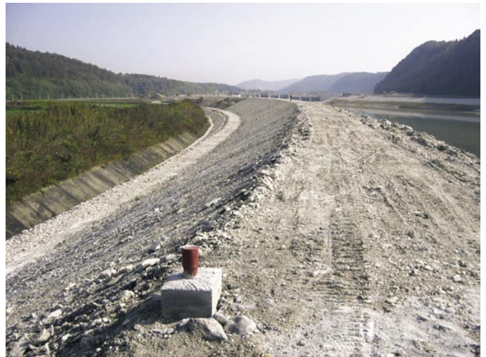
Energetski nasip iz gramoznega materiala s centralno tesnitvijo jet-grouting do neprepustne podlage zagotavlja potrebni hidravlični padec in hkrati rezervo vode za obratovanje v času konic porabe električne energije.
