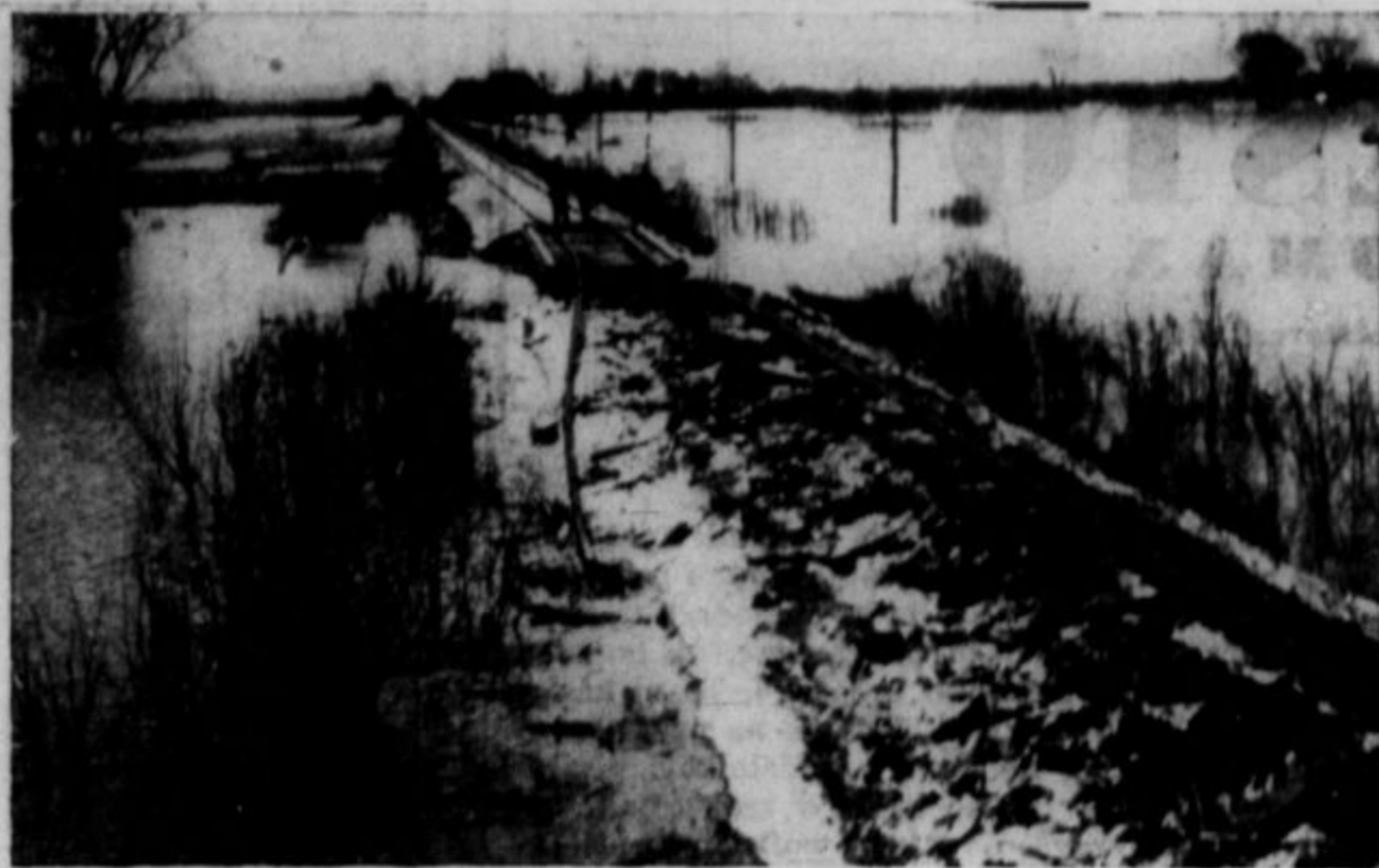
Deževja in povodnji so železnikiškim progam naj- večja nevarnost in temeljni vzrok zamudam. Pa tudi nerazočem. Vlak, tudi ako v nalivih vozi počasi, je vedno v nevarnosti, da zdrkne s tračnic. Lahko jih izpodkoplje voda, kak potoček pod mostom se spremeni v reko in izpodmaje temelj tračnic ali mostovža, ali se dogodi karkoli že, kar se pozneje pripise vodi. Nedavno se je dogodila nesreča na železnikiški progi pri Rocktonu, Ill. Nalivi so povzročili, da je brzovlak skočil s tira in več potnikov je bilo poškodovanih. Kako je izgledala proga na prizadetem mestu, ko so pobrali ob nji razmetane vagone, prikazuje gornja slika.
