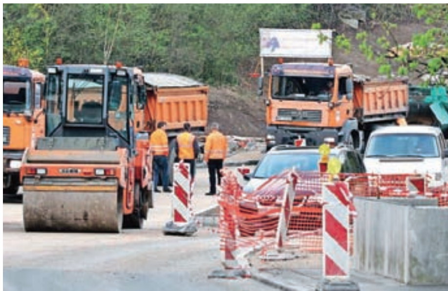
Novi koncesionar za vzdrževanje občinskih cest na območju občine Medvode je Gorenjska gradbena družba.
