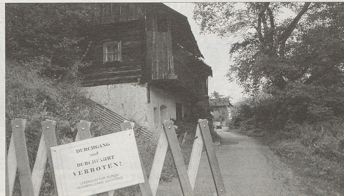
Hiša s številko 67 v Globasnici ogroža varnost na cesti, zato je občina cesto začasno zaprla.
