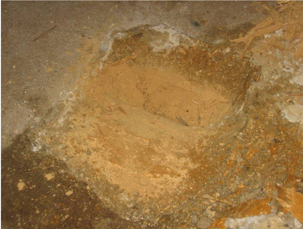
Slika 7.4: Globinska sonda je razkrila popolnoma prhle lesene stropnike, preko katerih je bil izveden cementni estrih brez ustrezne zaščite
