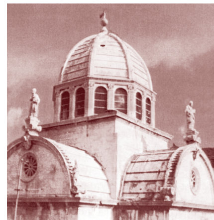
Pogled na poškodovano kupolo
