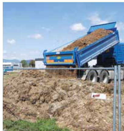
Sredi minulega tedna so v Žalcu že začeli z zemeljskimi deli pri gradnji novega vrtca.
