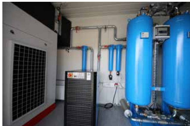
Slika 3 : Notranjost kontejnerske kompresorske postaje
