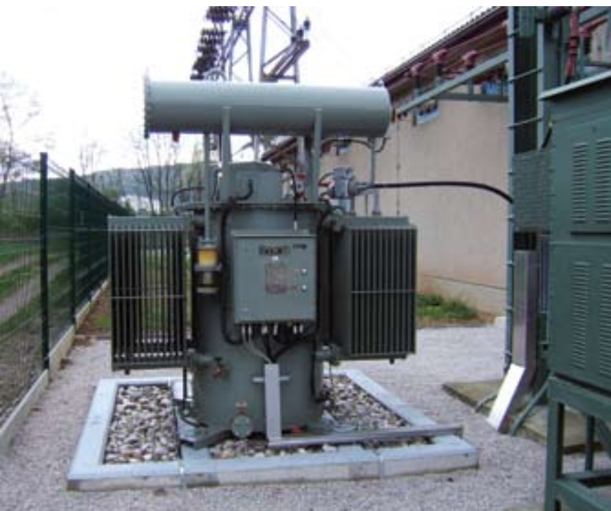
RTP 110 20 kV Krško DES - Petersenova dušilka
