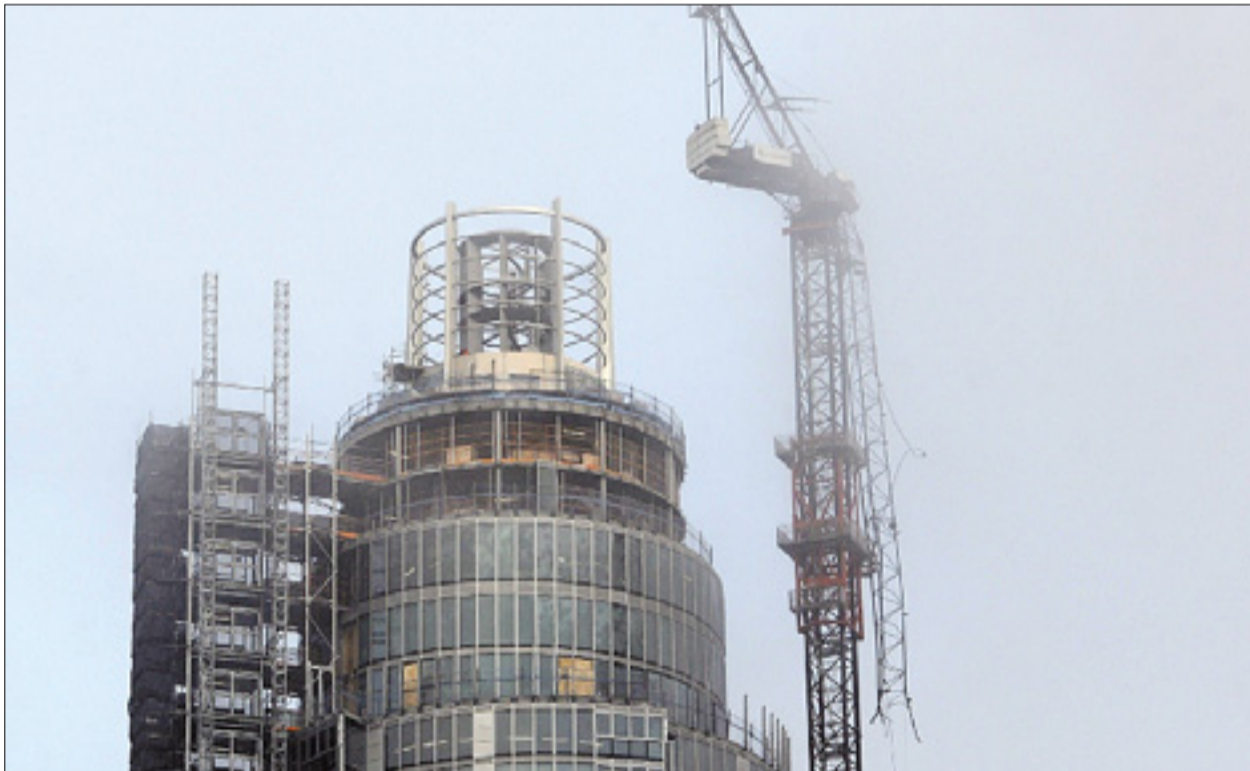
Poškodovan žerjav, v katerega je trčil helikopter
