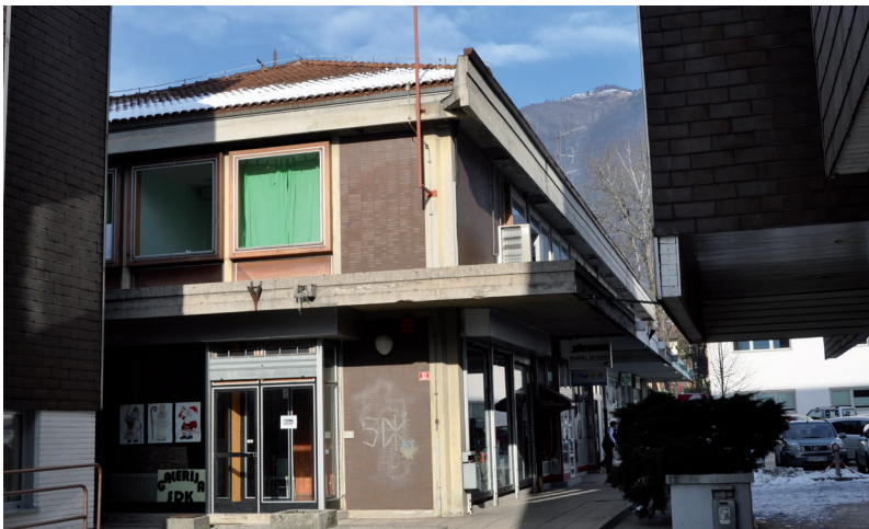
Slika 15: betonski nadstrešek stavbe SDK v Tolminu predstavlja toplotni most, za katerega je predvidena odstranitev
