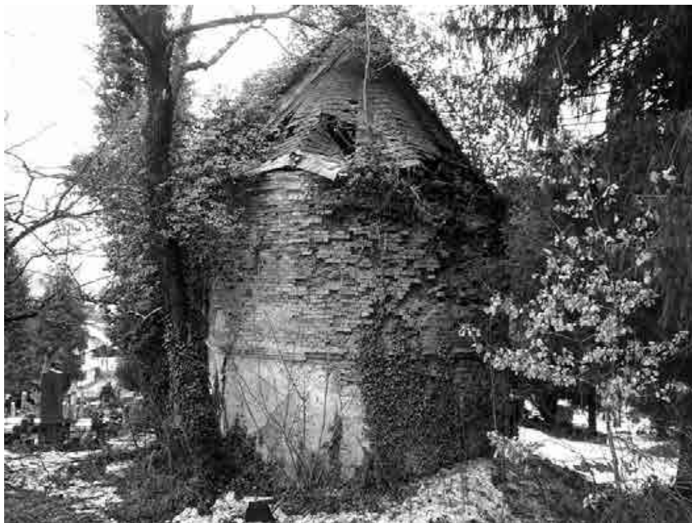
Apsidalna stran zunanjščine pozimi 2014: udrta streha, razpadajoči zidovi.
