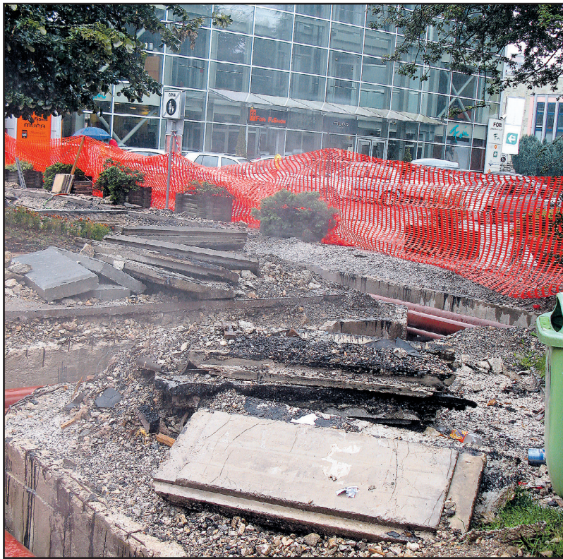
Gradbišče na promenadi sredi mesta je obdano z mrežo, saj na tem delu popravljajo napake na komunalni napeljavi.
