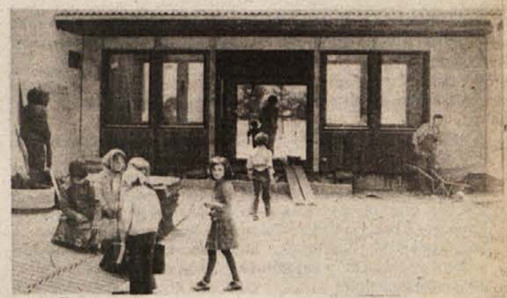
TUDI ŠOLA BODO PRENOVILI - Telovadnica osnovne šole v Sentrupertu bo kmalu dograjena. Te dni Marlesovi delavci dograjujejo se prehod, ki bo povezoval obe zgradbi; prehod je veljal 200.000 dinarjev. Ker je tudi stavba osnovne šole kar precej dotrajana, jo bodo še letos temeljito prenovili. Vodstvo šole je že zaprosilo za spremembo šolskega koledarja. Tako naj bi že po 10. juniju, ko bo telovadnica do konca nared, preselili vso opremo vanjo. Prenova šole, ki bo veljala 5 milijonov dinarjev, naj bi trajala do 11. septembra, ko bo začela šola običajno delovati. (Foto: SIMČIČ)
