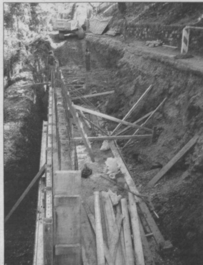
Sanacija zemeljskega plazu pod cerkvijo Sv. Lenarta (foto: J. Žvar)
