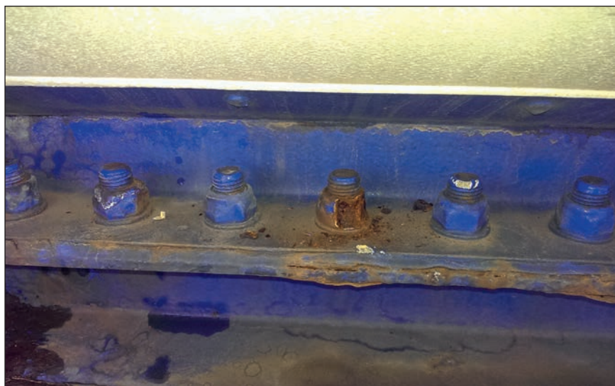
Slika 5. Poškodovani vijaki za pritrnitev cisterne na podvozje
