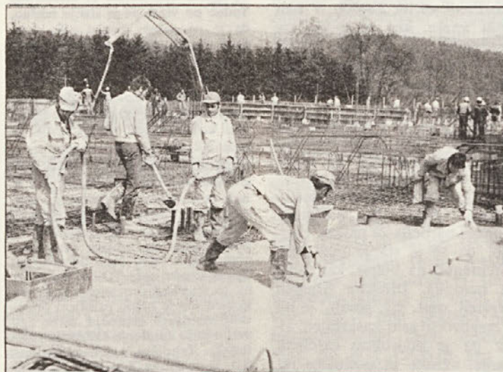
Ravnjanje plošče in delo z vibratorji na območju, kamor je potekal prenos betona z žerjavom. Ravnjanje plošče i rad vibratorima na področju, kamo se odvijalo prenošenje betona dizalicom.
