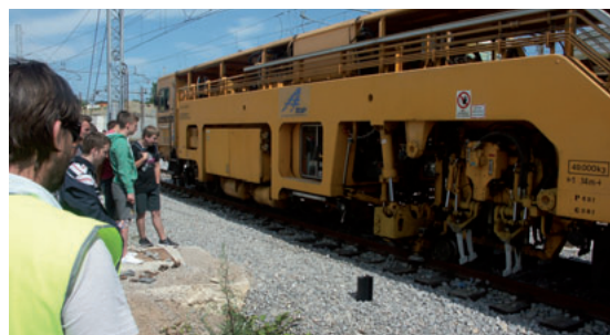
Dijaki pri ogledu nivelirnega ravnalnika na tirih tovarne postaje Koper
