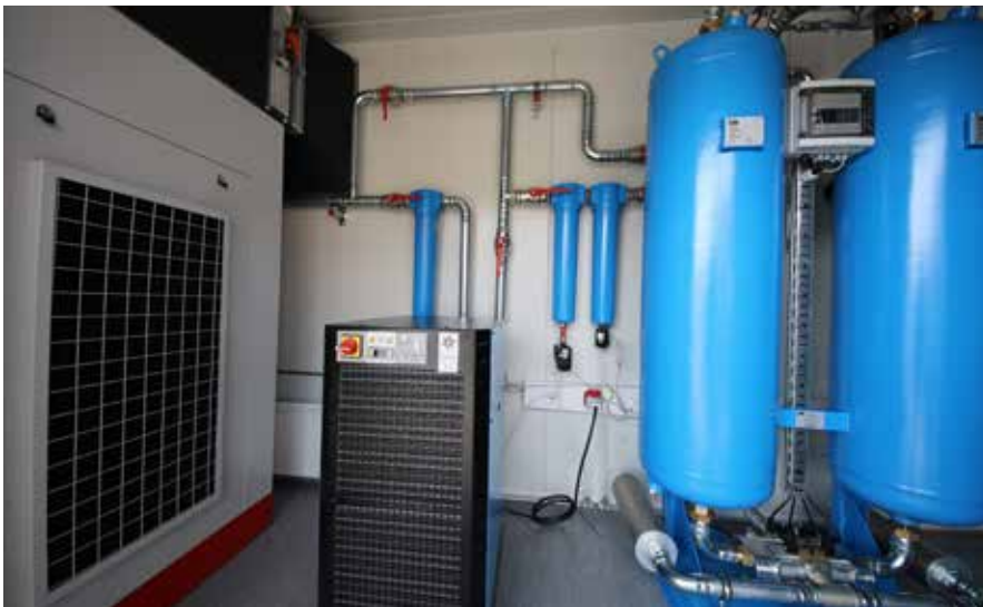
Slika 3 : Notranjost kontejnerske kompresorske postaje
