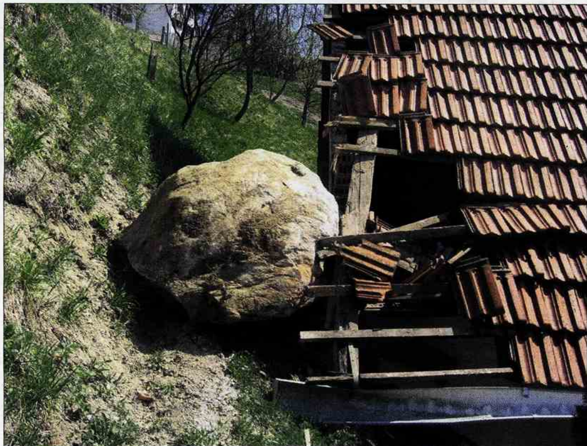
Skala, ki je pred dnevi prebila streho. Zlahka bi zadela tudi fasado. (Foto: arhiv družine Zupanc)
