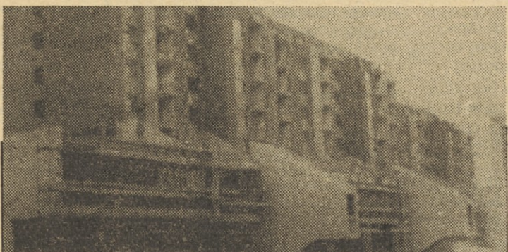
Delavci SGP »Projekt« Kranj dokončujejo v Kranju eno največjih poslovno-stanovanjskih stavb v mestu. V pritličju bodo trgovski lokali, v prvem nadstropju poslovni prostori. Nad njim pa še 61 družinskih stanovanj. Predvidevajo, da bo poslopje, ki stoji ob cesti JLA, nared do konca tega leta. Na sliki: Pogled na eno največjih poslovno-stanovanjskih zgradb v Kranju.
