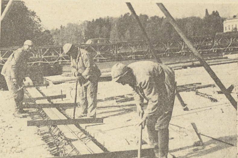
Zidarji Ivan Korotaj, Albin Senekovič in Martin Vorošič spenjajo betonsko železje v diletaciji na novem mostu čez Muro v Gornji Radgoni
