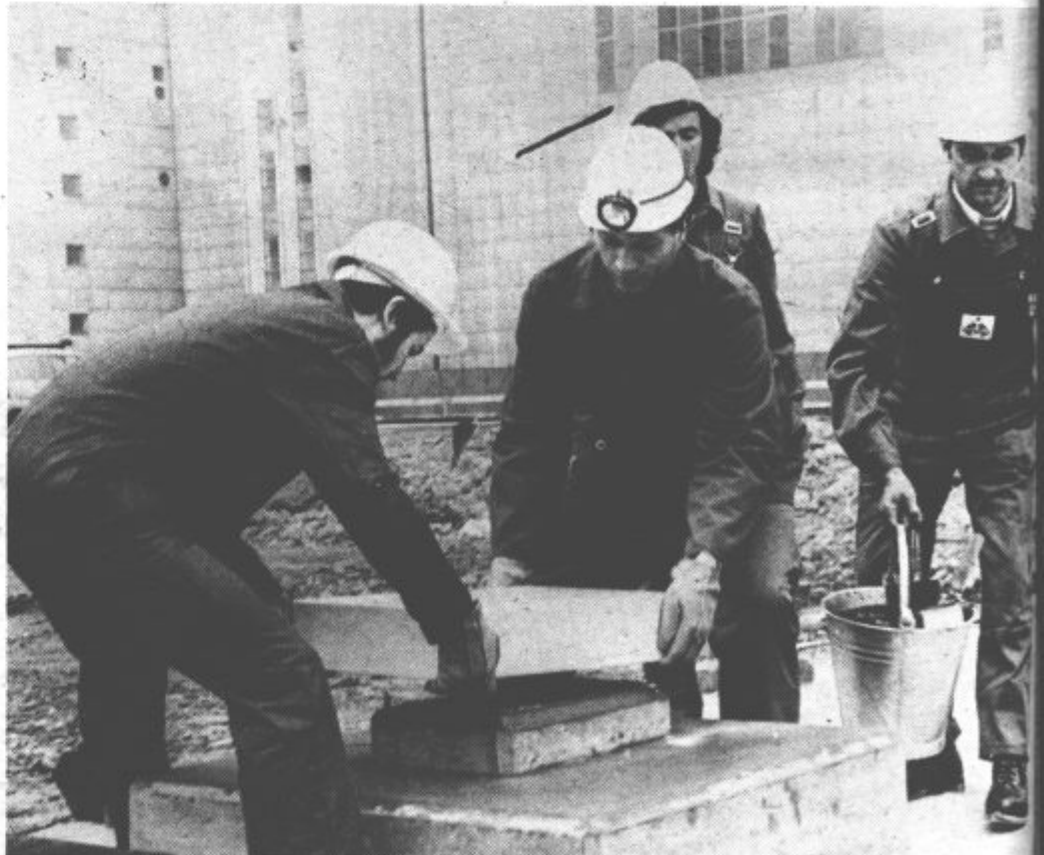
Na malto, ki so jo pripravili delavci celjskega Gradisa, sta delavca Alojz Špegel in Ivan Črep položili temeljni kamen z napisom „TE Šoštanj IV smo pričeli graditi 1. 2. 1975. REK TOZD TES“.
