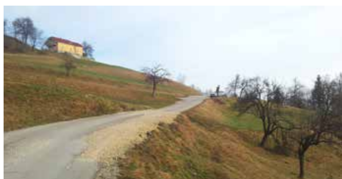
Plaz na cesti Javornik-Svetli Dol-Kanjuce »Križišče« - pred sanacijo
