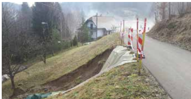
Plaz na cesti Javornik-Svetli dol-Kanjuce - »Pri Jelenc« pred sanacijo
