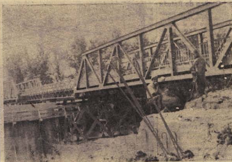
Poslovna enota za nizke gradnje iz Maribora, ki je enota ljubljanskega Gradisa, bo do dneva republike, če bo vse po sreči, končala nov most v Metliki. Čez Kolpo vozijo zdaj po zasilnem mostu, delavci pa že postavljajo betonske nosilce v vodi (Foto: Splichal).
