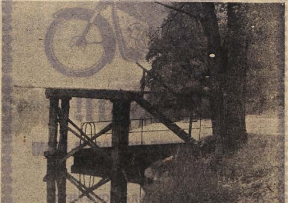
Zalpstni ostanki skakalnega stolpa na Loki se ogledujejo v gladini Krke, za njim pa je betonsko stopnišče z ograjo, edini izpolnjeni del obljube iz leta 1962. Naj dodamo še, da je bilo tistega dne, ko je bil narejen ta posnetek, oblačno in je bilo kopališče zato prazno
