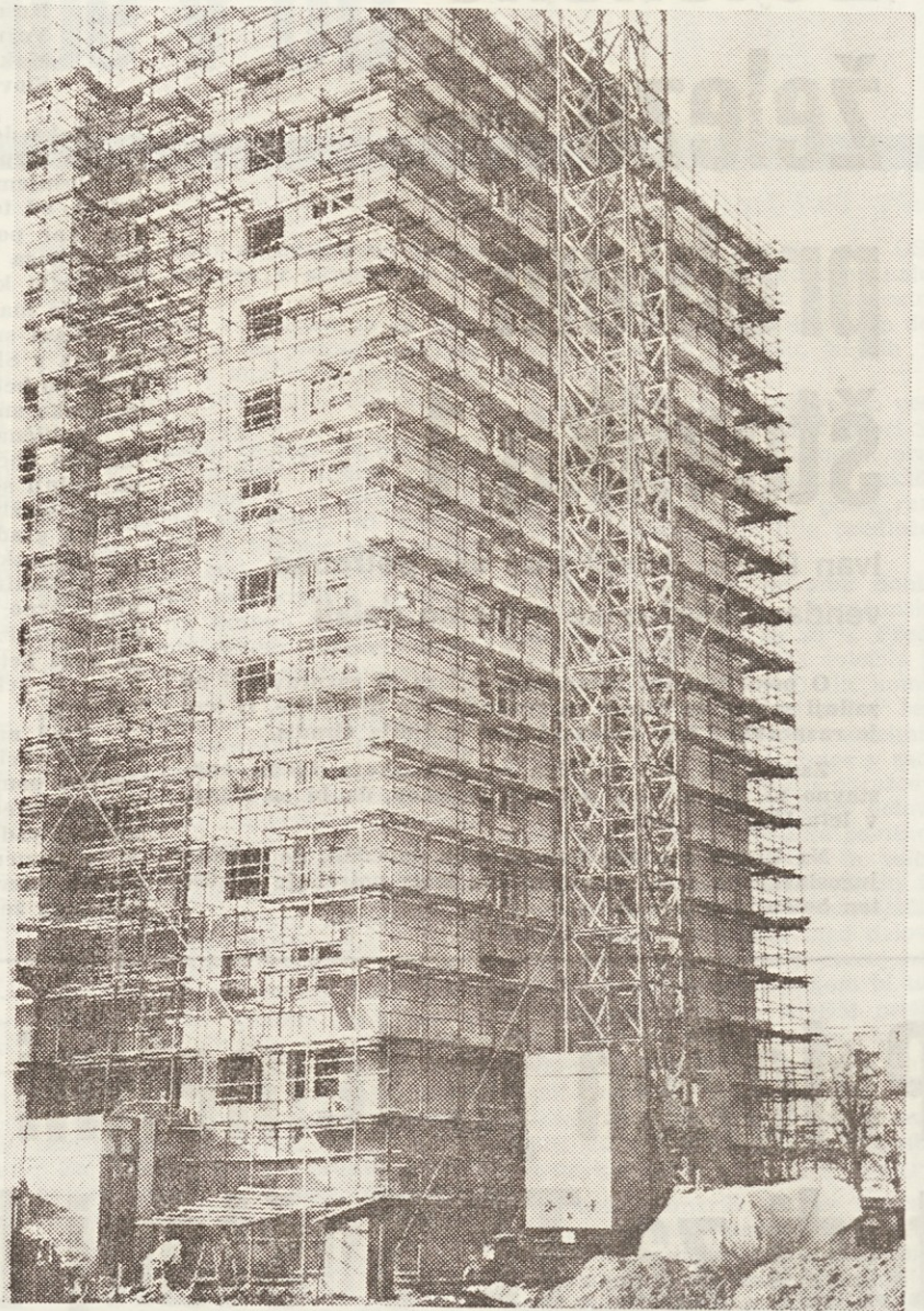
V tej stolpnici bo 72 stanovanj
