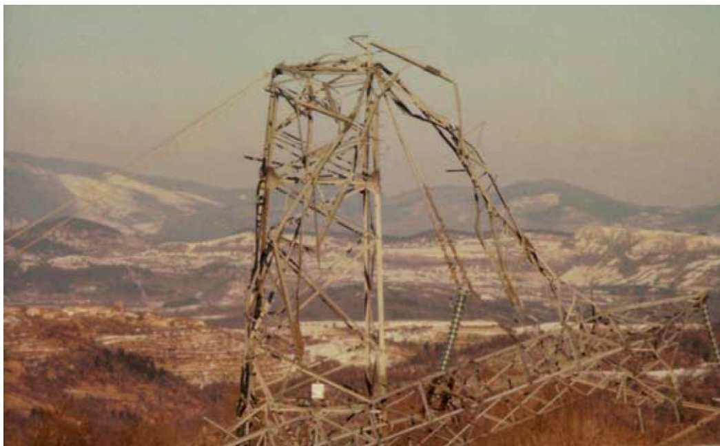
Slika 2: Zaradi teže ledenega oklepa in vetra je bilo na območju Brkinov novembra leta 1980 zelo poškodovano tudi daljnovodno omrežje. (Vir: Arhiv GIS)
