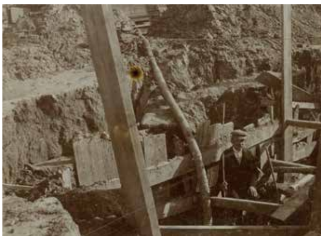
Gradbena jama za novo skladišče Tobačne tovarne v Ljubljani, 1910. (SI_ZAL_LJU/0342, Fototeka A2-056).
