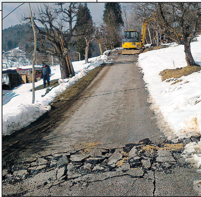
Plaz v Ložnici je močno poškodoval cesto.
