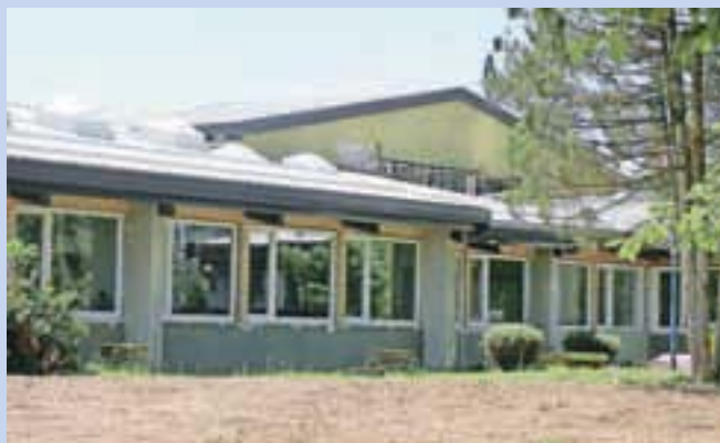
V okviru energetske sanacije so na šoli v Pirničah že zamenjali del strehe in okna.
