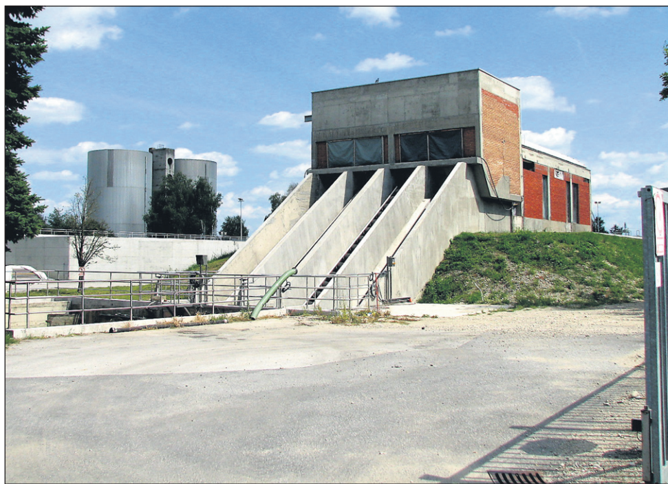
Po stečaju glavnega izvajalca v začetku letošnjega leta, Cestnega podjetja Maribor, se je rekonstrukcija dela na čistilni napravi povsem ustavila.
