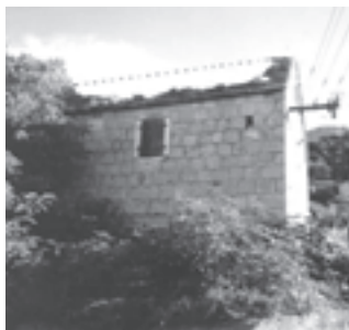
Slika 8: Derutni gospodarski objekt sa urušenim krovom i srušenom unutrašnjom konstrukcijom. Dilapidated out-building with collapsed roof and demolished internal structure.
