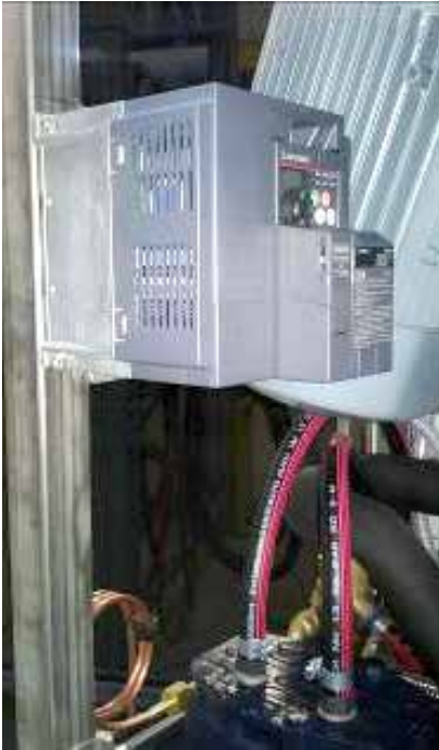
» Slika 2: Naprava Diagonal Freezer z vgrajenim pretvornikom FR-E700, ki omogoča nemoteno delovanje naprave, tudi ko pogonski motor preseže svoje zmogljivostne omejitve, ter preprečuje izpad delovanja. Razpoložljivost in proizvodna učinkovitost naprave sta tako izboljšani.
