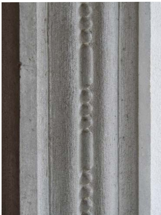
Slika 2: Valoviti profil na licu pokončnika portala cerkve v Gornji Košani, ki ga krasijo bisernik in za Severja značilna drobna klinasta utora.
