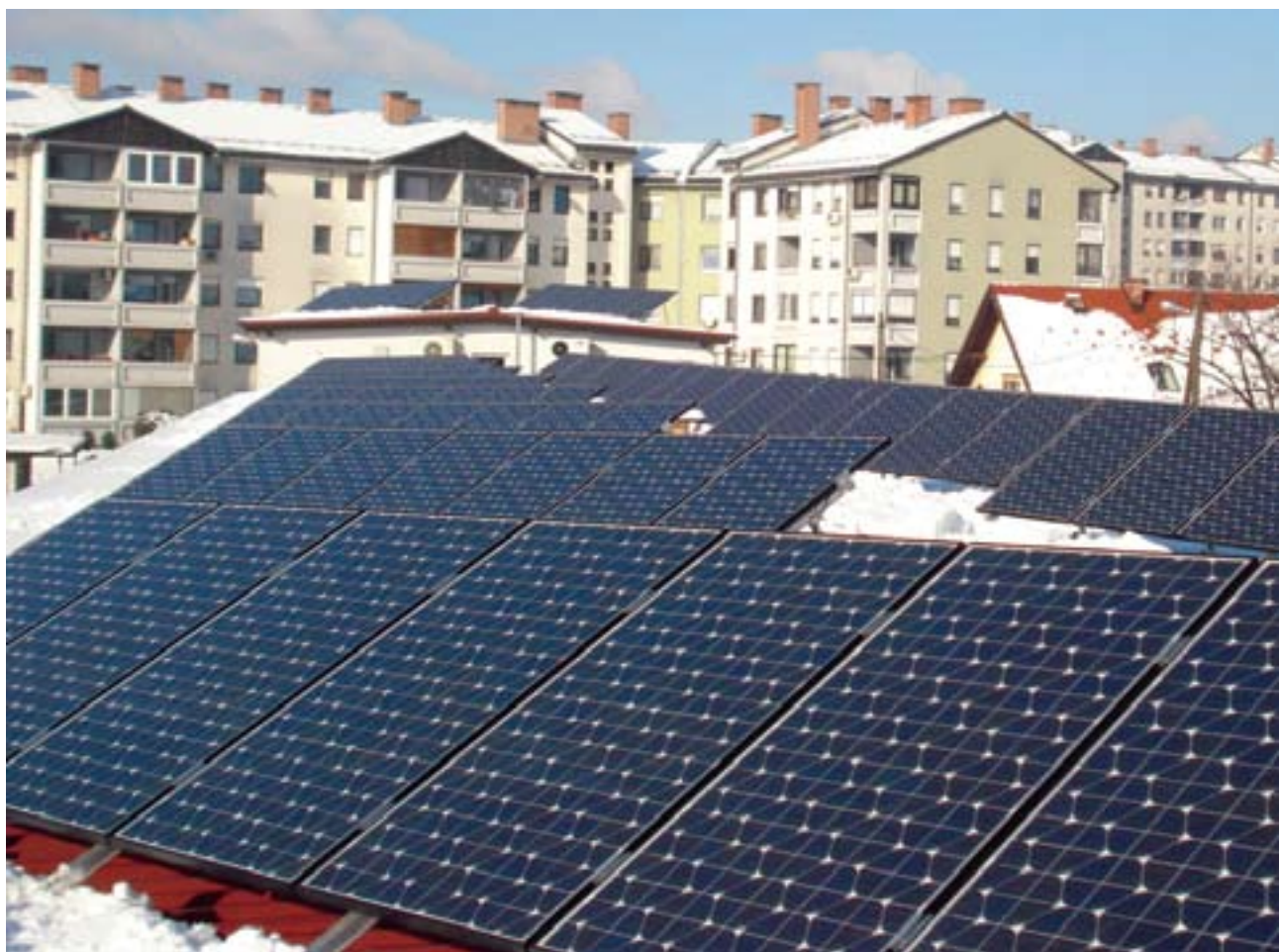
Nadgrajena sončna elektrarna v Radvanju je bila priključena na distribucijsko omrežje 22. decembra lani.
