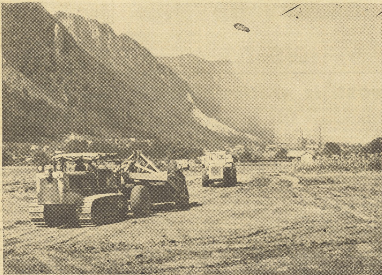
Dela na Belškem polju potekajo z nezmanjšano brzino. Do konca aprila smo izkopal in prevozili že 253 tisoč m 3 ali 39 % materiala. Vsa dela morajo biti končana do oktobra tega leta
