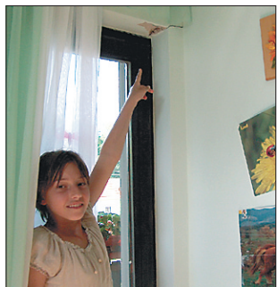
Muhičeva hči Karmen: "Tu v moji novi sobici se je nad vrati odluščil kar cel kos zida v kotu!"
