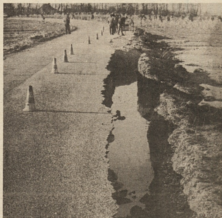
Ko je voda odtekla, se je šele pokazalo, kakšna je bila njena uničujoča moč. Cesto med Brežicami in Dobovo že popravljajo.
