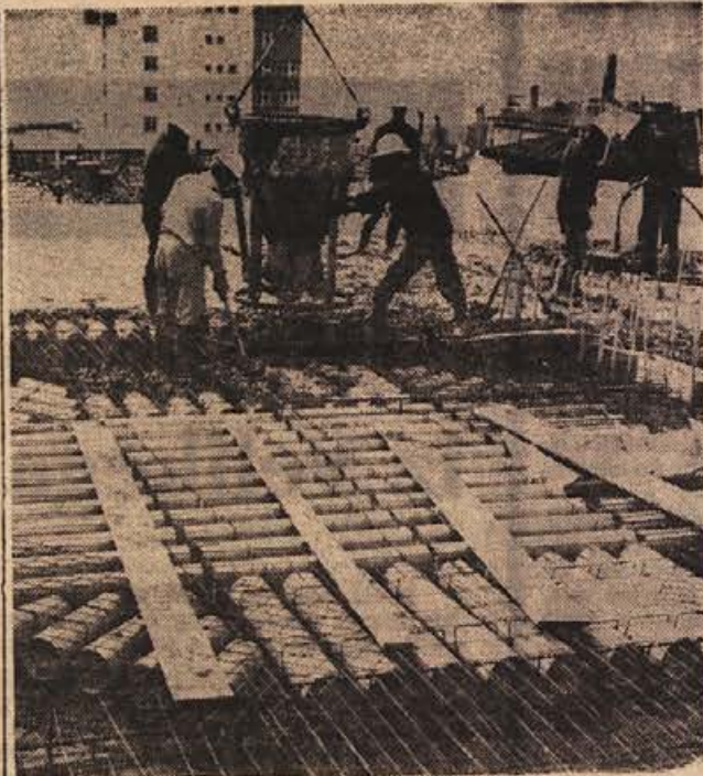
ZIDAR iz Kočevja je uvedel gradnjo stropov iz kartonskih cevi, kar je novost, ki gradnje tudi poceni. Prvič grade na tak način na gradbišču na Reki.
