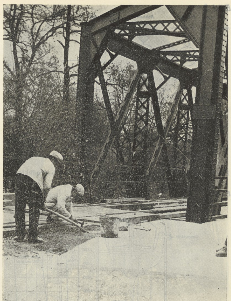
Še nekaj kock pred mostom in cestni tlak in most bosta gotova
