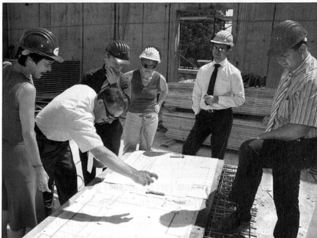
Generalni direktor Direktorata za šport Simon Starček (drugi z desne) si je ogledal gradbišče športne dvorane v Mozirju
