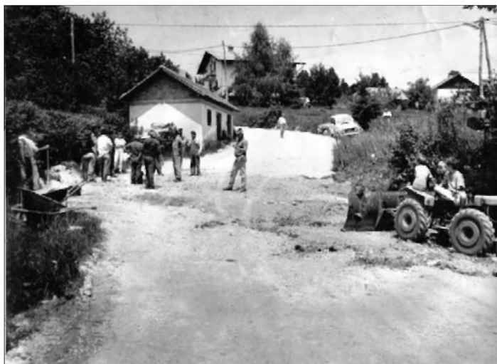
Milan Zelnik je bil pravi mojster pri motivaciji ljudi za delovne akcije (Priprava cestišča za asfalt na Gradež, maj 1990).
