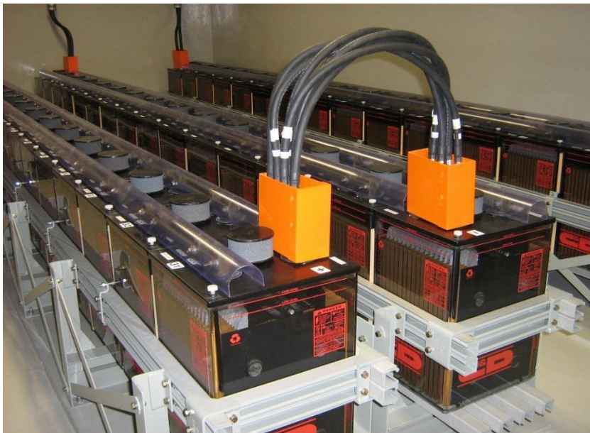
Slika 67: Varnostna baterija v bunkerski zgradbi (Foto: inšpekcija URSJV)
