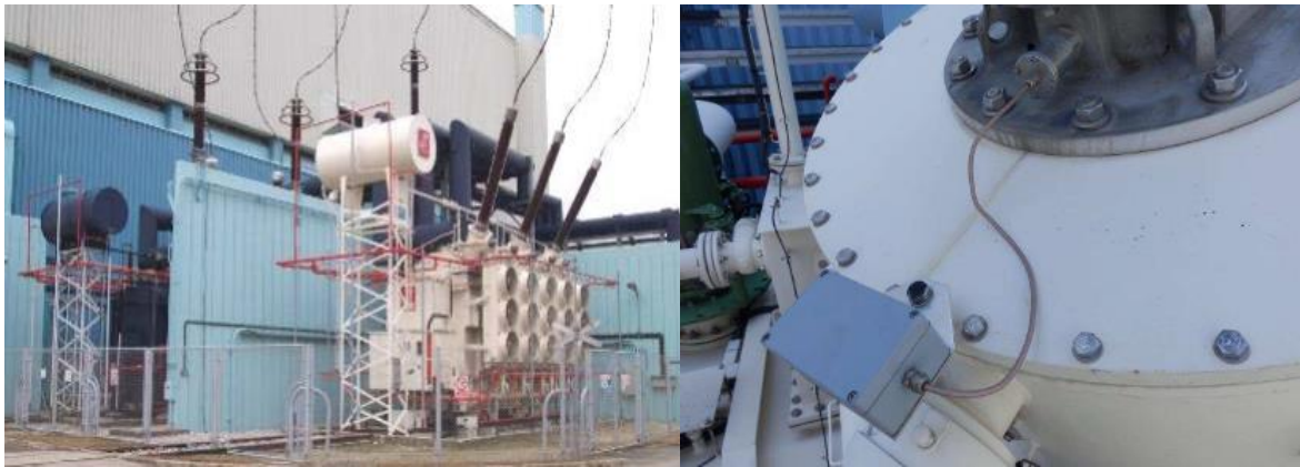
Slika 50: Glavni transformator GT1 (levo) in izvedba meritve napetosti skozi skoznik faze C na glavnem transformatorju GT2 (desno)
