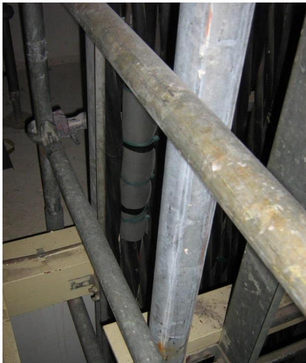
Slika 73: Vertikalni kabelski kanal z začasno saniranim kablom (Foto: inšpekcija URSJV)
