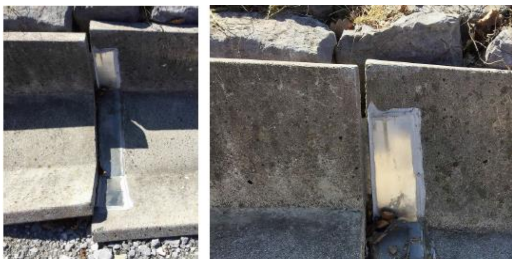
Slika 92: Poškodbe na kanaleti, stanje december 2018
