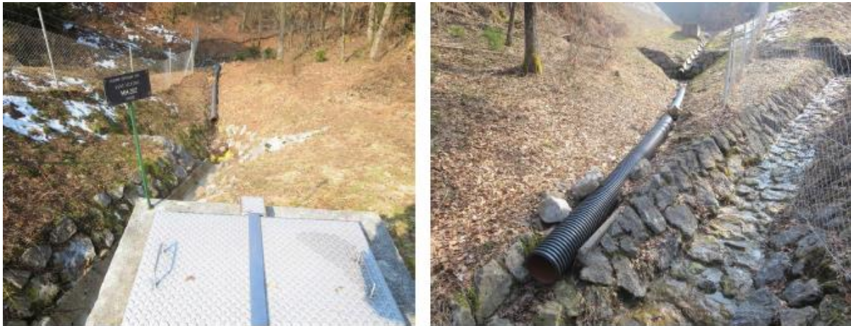
Slika 89: Merilno mesto, kjer je bil premeščen poškodovani kanal
