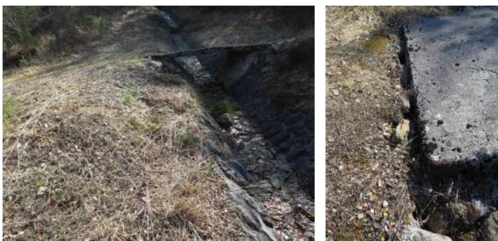
Slika 91: Razpoka ob kanalu zahodnega Boršt potoka
