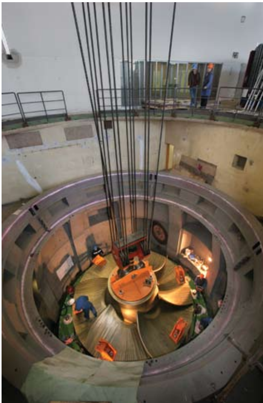
Spust gonilnika v spodnji del turbinskega jaška.
