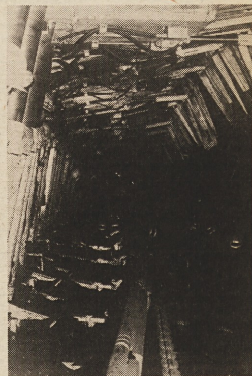
Hidravlično podporje Dowty v velenjskem rudniku. Neprimerno bolj varno je kot klasično podporje s kovinskimi stojkami, katerih vsaka zdrži na ozki širini svojega profila 40 ton pritiska. Hidravlično podporje, razdeljeno na »sekcije«, široke 1,5 metra, zdrži na vsaki sekciji do 350 ton pritiska. Žal pa velja skupaj z odkopno mehanizacijo polnih 50 milijonov dinarjev...
