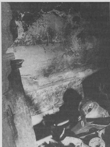
Sl. 9. Del severozahodne stene v hišnem vhodnem prostoru. Delno odpadel glinast omet je dveh vrst: v gradivu, ki tesni špranje med dvema tramovoma, ni dodanega vlaknastega veziva, v vrhnjem, pač poznejšem ometu pa je narezana slama. ♦ Part of the north-western wall in the entrance hall. The partly fallen off plaster was of two types; the material which closes the gaps between beams contains no fibre binder added, the top coat which was added later, however, contains cut straw. ♦ Partie du mur nord-ouest de l'antichambre. La couche d'argile, partiellement détachée, est de deux types différents: le matériel qui rend étanches les fentes entre les poutres ne contient pas de fibres, tandis que la couche superposée ultérieurement contient de la paille coupée.
