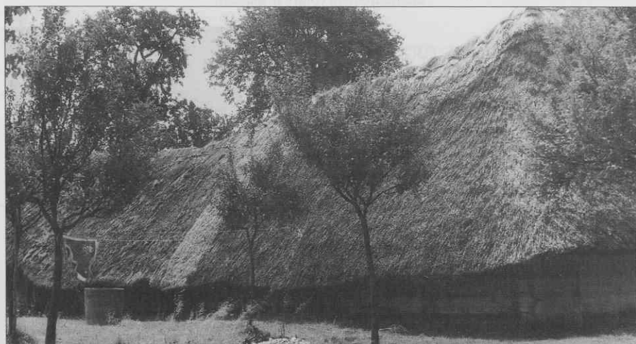
Sl. 4. Pogled s severa na poznejše in večje gospodarsko poslopje, prislunjeno k hiši; desno je viden severni hišni vogal, nad katerim se streha zalomi v obliko črke L. ♦ View from the north to the later, bigger outbuilding, built on to the house; to the right the northern corner of the house above which the roof bends to become L-shaped. ♦ Vue du Nord sur le bâtiment plus récent et plus grand, appuyé contre la maison; à droite, on voit l'angle nord au-dessus duquel le toit forme un L.
