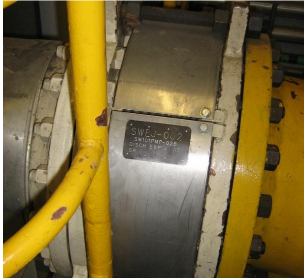
Slika 67: Zaščita ekspanzijskega spoja tlačnega dela cevovoda bistvene oskrbne vode (Foto: inšpekcija URSJV)
