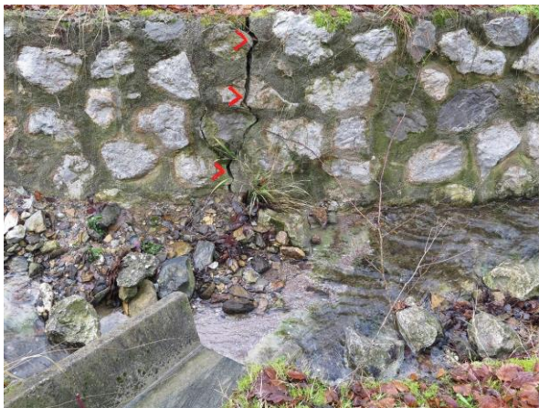
Slika 80: Razpoke v odvodnem kanalu pod merilnim mestom BPG
