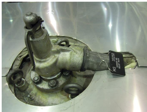
Slika 71: Razbremenilni ventil na dogrevalniku pare in izločevalniku vlage (Foto: NEK)
