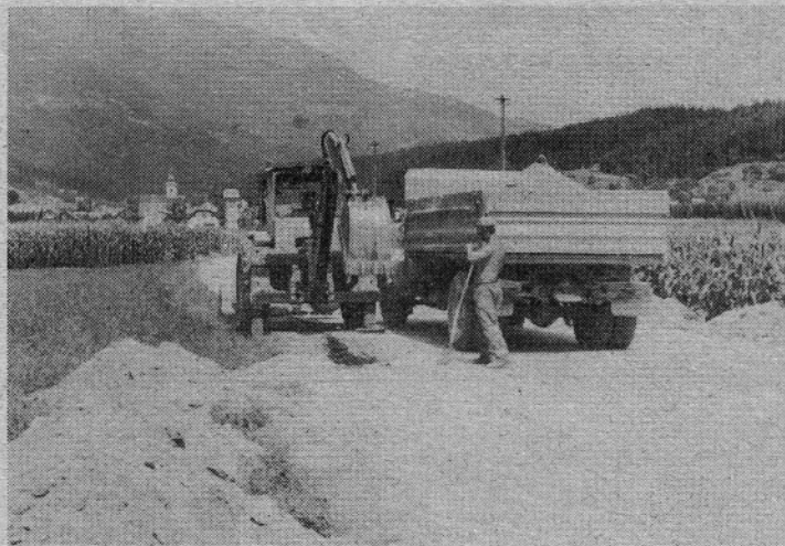
Pred dnevi so končali z deli na krajevni cesti, ki povezuje Rečico z glavno cesto. Cesto so razširili, tako, da je sedaj široka 5 metrov in jo prevlekli z novim asfaltnim slojem. Stroške obnove ceste, katerih je bilo za 90 milijonov, je nosila cestno-komunalna skupnost Mozirje, nekatera dela pa so opravili Rečičani sami.
