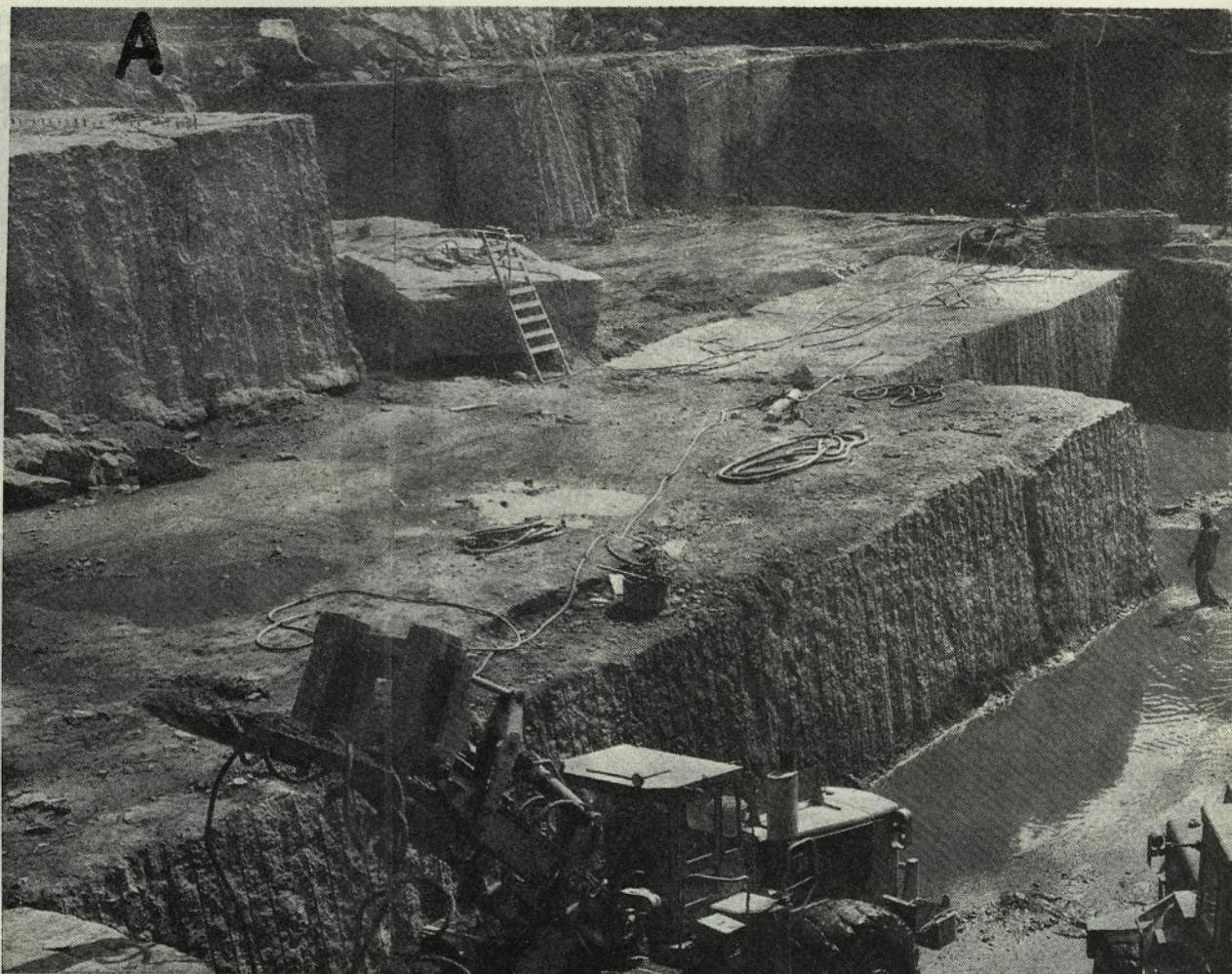
Fotografija modernega kamnoloma A — minsko polje, pripravljeno za odstrel Nakladalniki nadomeščajo vitla in »Derick« dvigala (brošura Tamrock)
