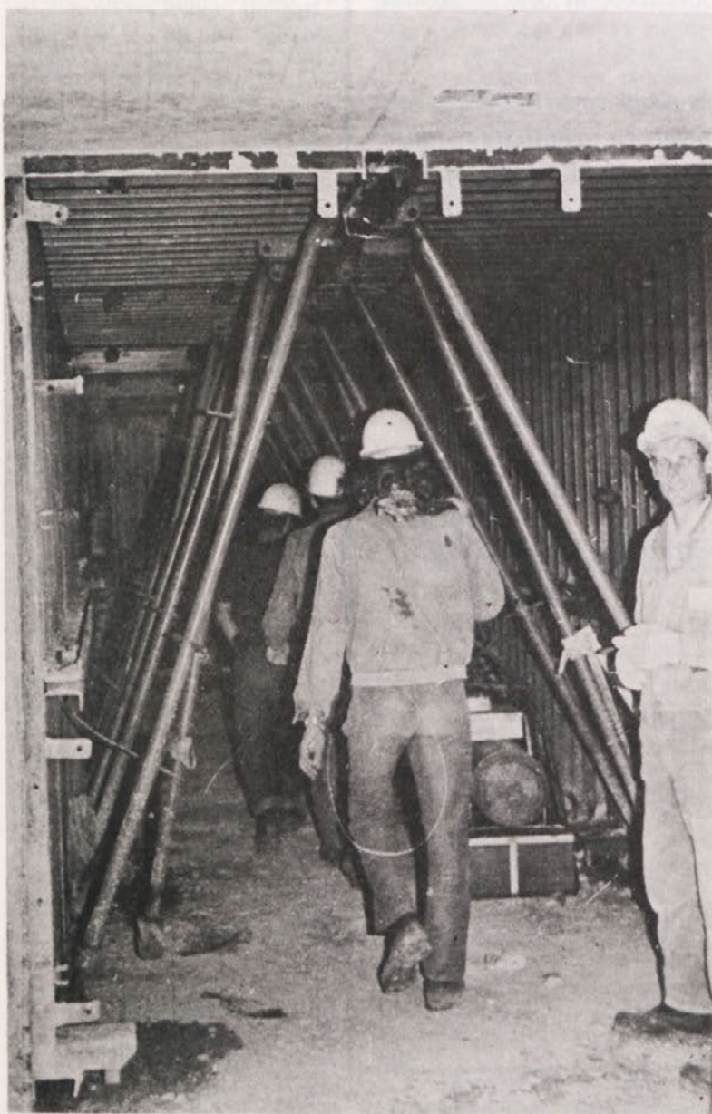
Notranjost jeklenega OUTINORD opaža je res podobna tunelu, zato tudi rečemo temu opažu tunnelski opaž
